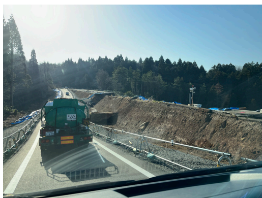
地震によって道路が寸断されたり、道幅が制限されていたりしました。
